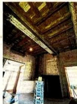
Das Foyer heute: Der Blick nach oben offenbart die maroden Deckenbalken.
