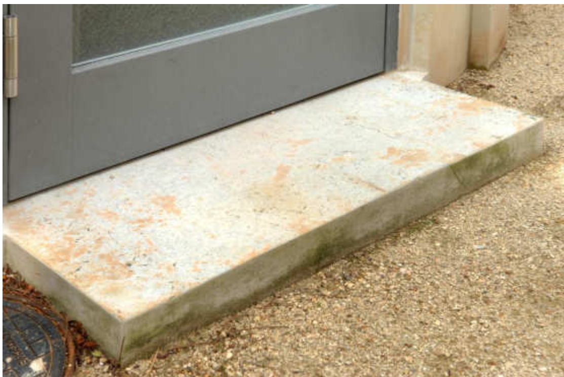
25.10 Sandsteinpodest Eingang Nordseite 500 €
