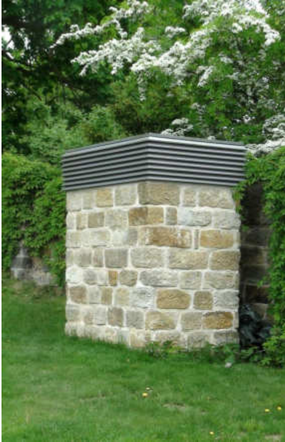
5.8 Bauwerk Lüftungsanlage Ansaugöffnung 4.000 €
