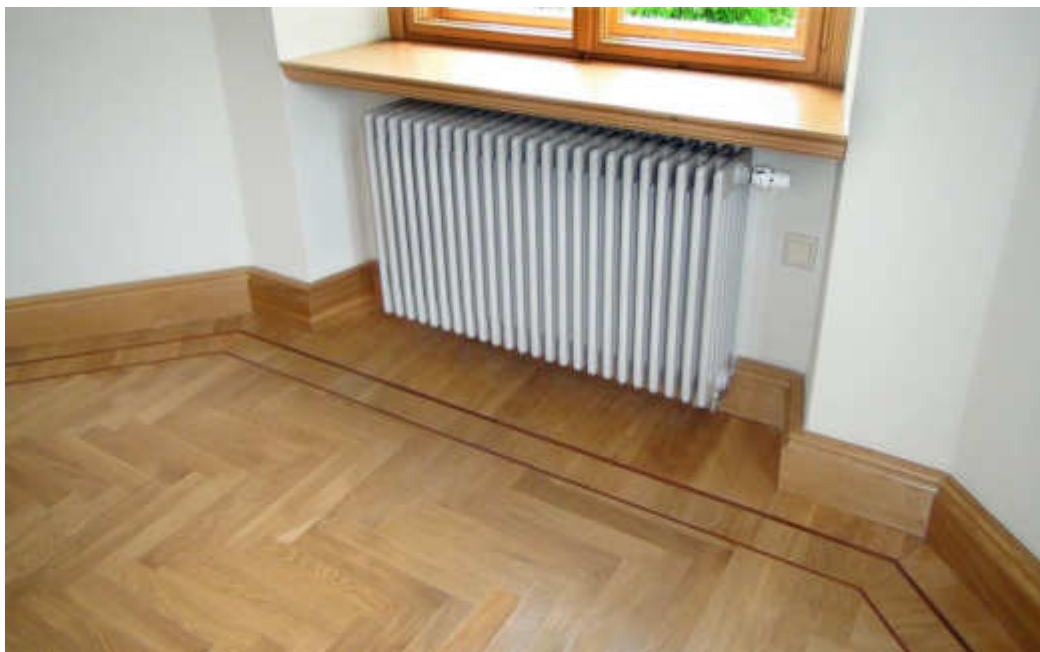
15.4 Heizkörper 3x je 500 €
