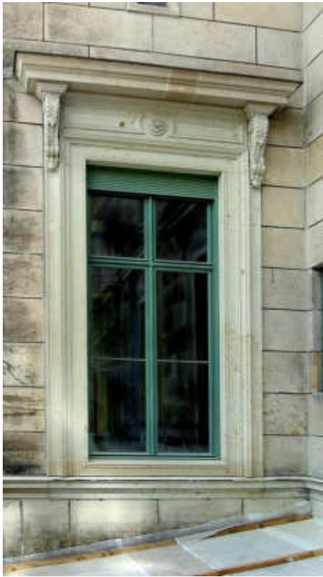
1.1 Historisches Fenster OG Ostturm Balkonseite 3.800 €
